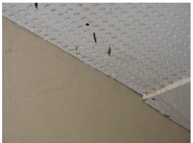
Bild 6: Decke Umkleideraum Mädchen (unsauberer Gesamteindruck)
