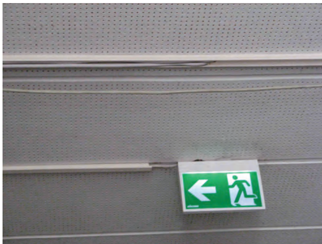
Bild 3: Decke im Flur 2. OG (unverkleidete, von der Decke herabhängende Stromkabel)
