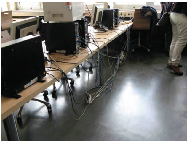
Bild 11: Computerraum (Nicht vorschriftsmäßige PC-Verkabelung)
