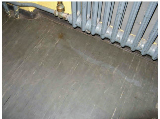
Bild 4: Raum 15 (Maroder Heizkörperanschluss leckt!)
