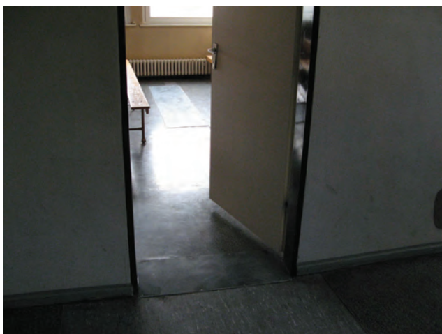
Bild 5: Umkleideraum Jungen (geflickter, glatter Boden => Stolper- und Rutschgefahr)
