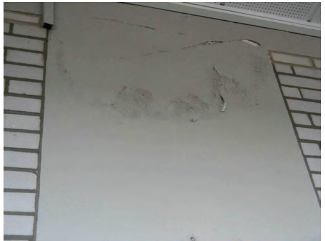
Bild 2: Wand im Flur 2. OG zwischen R 23 /R 24 (Wandbelag löst sich ab!)
