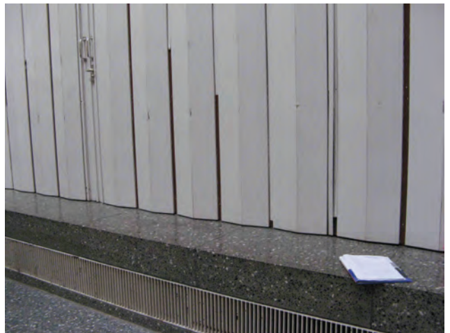
Bild 10: Aula/Pausenhalle (Trennwand zur Bühne/Musikraum mit Absplitterungen)
