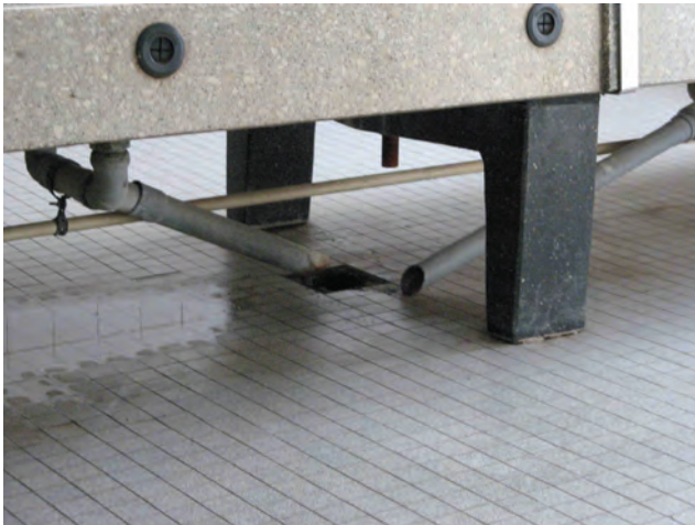
Bild 7: Waschraum (Marode Wasserableitung)
