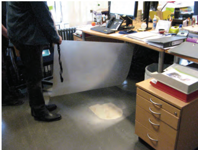
Bild 1: Sekretariat (ausgebesserter Fußboden, improvisierte Abdeckung; Raumnot!!!)
