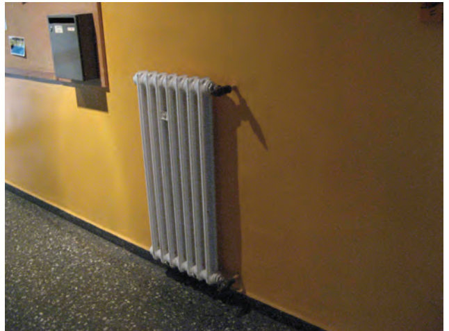
Bild 8: Aula/Pausenhalle (einziger(!) Heizkörper)
